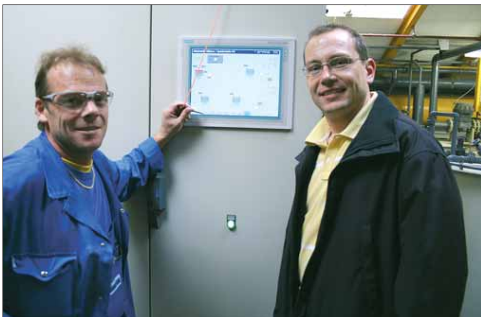
Mike Eichelberger, Geschäftsführer der Spaltag (rechts) mit seinem Mitarbeiter Meinrad Meier vor dem Steuerschrank einer der Behandlungsanlagen. (Fotos: Robert Meier)
