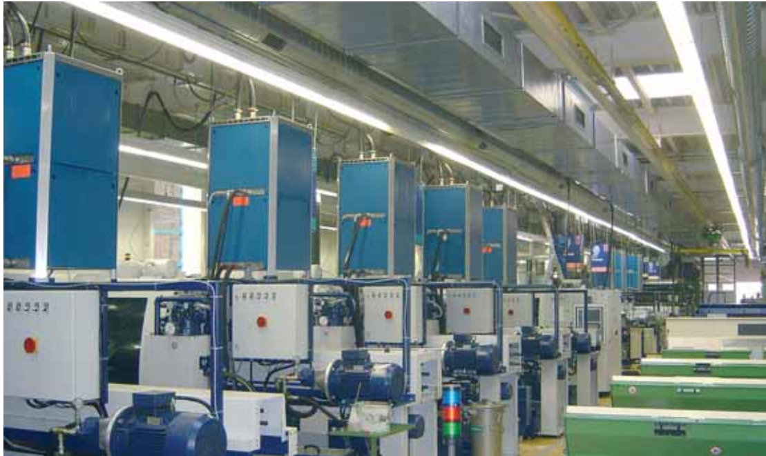
Alle Maschinen sind an eine zentrale Absauganlage angeschlossen und arbeiten prozesssicher nahezu rund um die Uhr.
