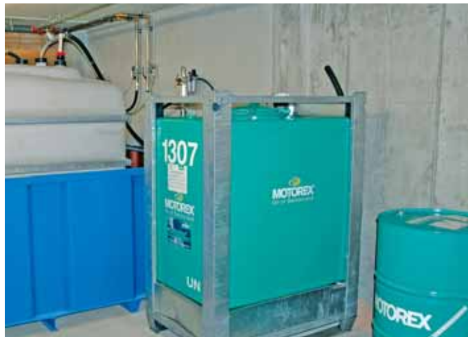
Das zentrale Bearbeitungs-Fluid-Lager im Untergeschoss senkt den Logistik-Aufwand deutlich. Lieferungen und Abtransporte können rationell und nach den geltenden Sicherheits- und Umweltnormen durchgeführt werden.
