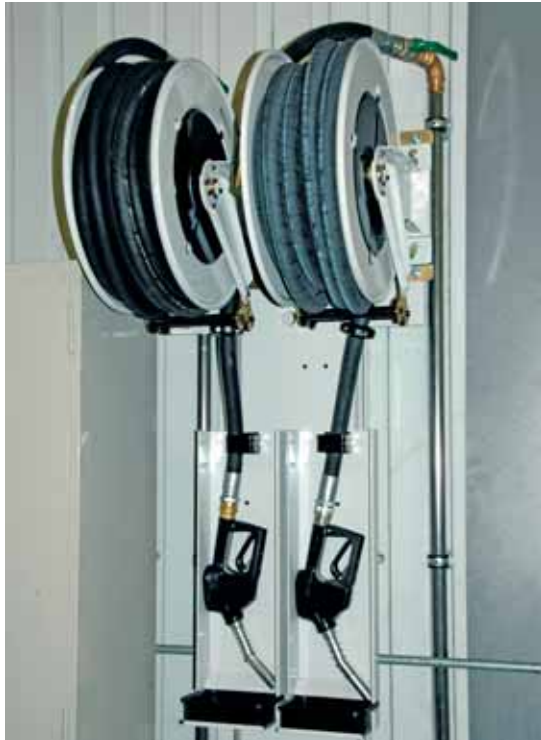
Mit den wandmontierten Schlauchrollen lassen sich die Versorgungscontainer zentral und in der Nähe der Maschinen befüllen. Eine Füllstandsanzeige am Container und eine Abstellautomatik schützen dabei vor dem Überfüllen.
