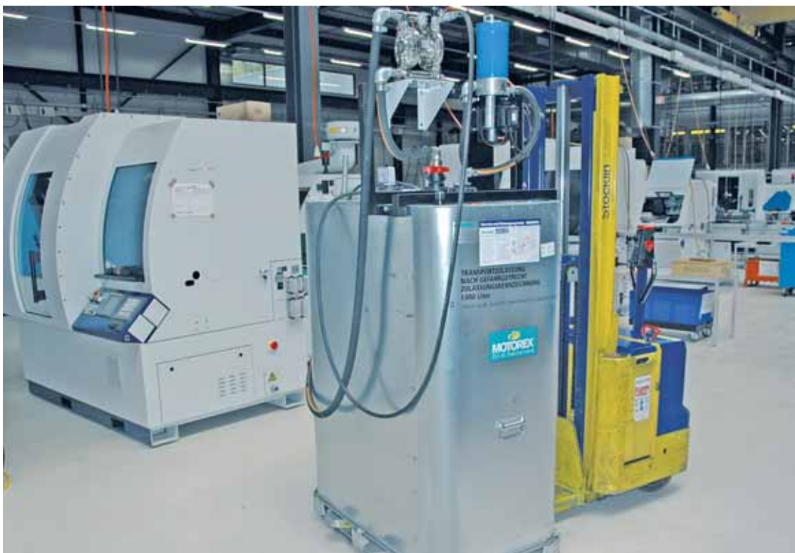
Für die Befüllung und Entleerung der Maschinen stehen mehrere dieser doppelwandigen Container zur Verfügung. Sie sind wie Paletten transportierbar und jeweils mit einer Pumpe und einer Filter-Einheit ausgerüstet.
