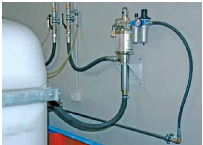
Leistungsstarke pneumatische Pumpen versorgen die Fluid-Versorgungs-Säule an der zentralen Ausgabestation in der Maschinenhalle. Dank dem universell einsetzbaren Schneidoel MOTOREX ORTHO NF-X konnte das Fluid-Handling extrem vereinfacht werden.
