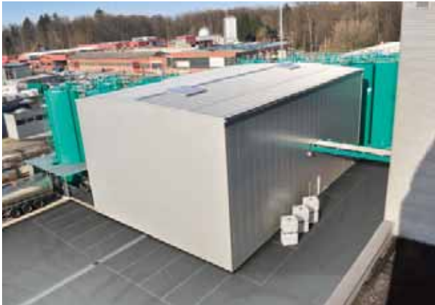
Grazie al nuovo parco di cisterne con recinzione integrale e dispositivo di pulitura, il leader svizzero della lubrificazione pone ancora una volta la qualità al posto d'onore.
