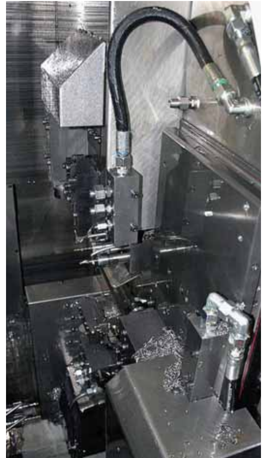
An den Werkzeughaltern angebrachte HPC-Leitungen.
