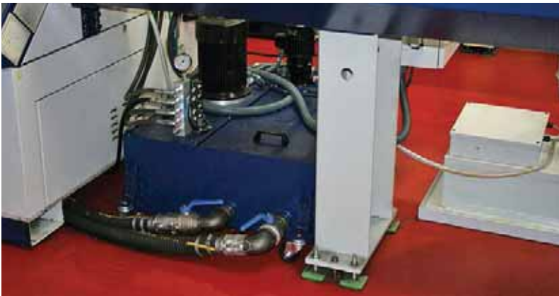
An der Tornos Deco nachgerüstete HPC-Pumpe.
